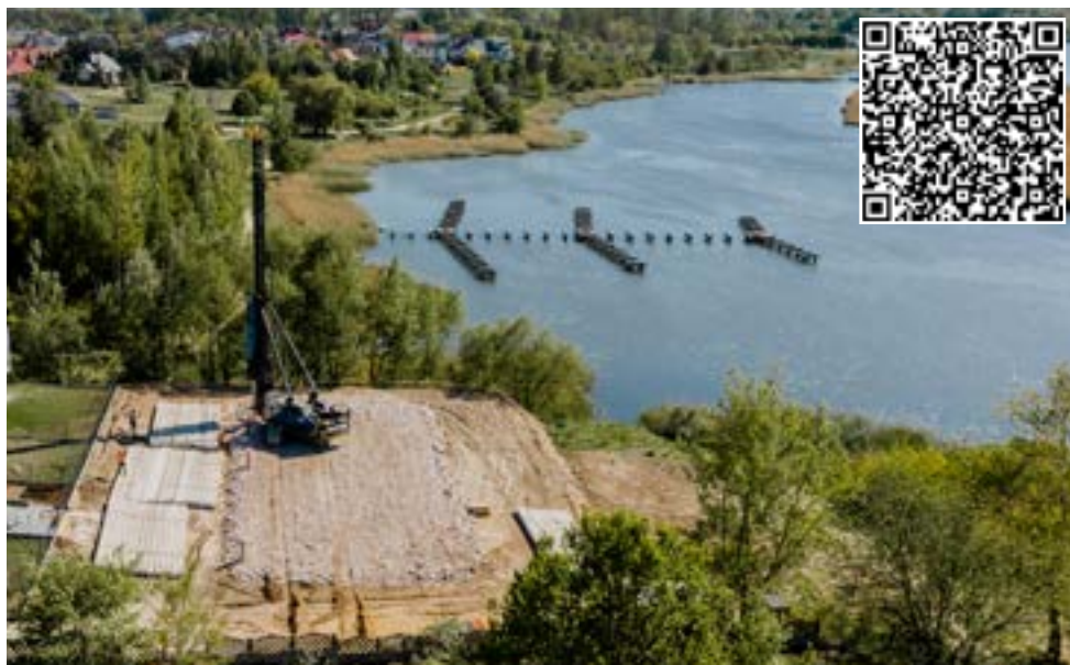
Fundamenty palowe dla domów szeregowych. Zeskanuj kod QR i zobacz film z tej realizacji.
