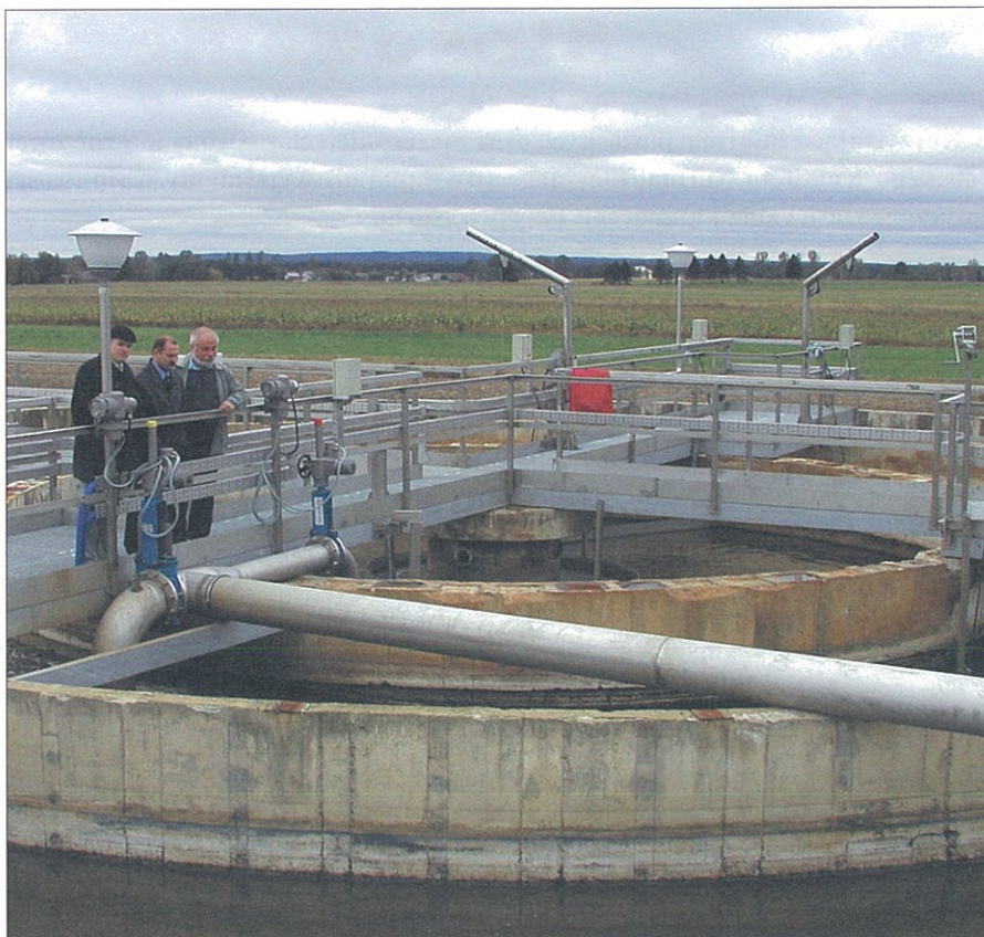
Zmodernizowane Biooxybloki, na których spoczywał kompletny proces oczyszczania, teraz doskonale realizują wstępne oczyszczenie beztlenowe i procesy niedotlenione.
