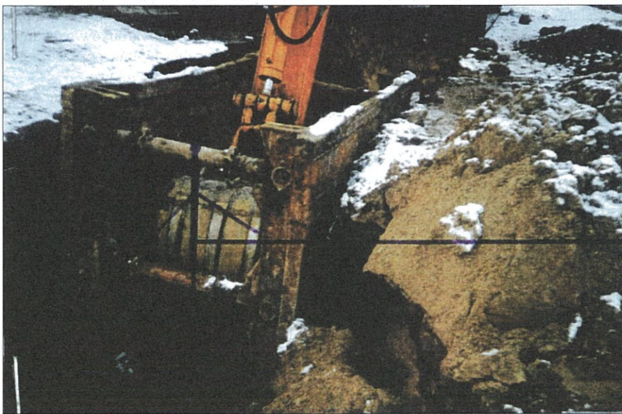
Widok na wykop wąskoprzestrzenny w ulicy pod budowę kanalizacji sanitarnej. Widoczny brak zabezpieczeń ścian wykopu przed osunięciem się
