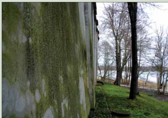
Powyższe zdjęcia przedstawiają uszkodzenia w budynkach i budowlach zabytkowego zespołu klasztorowego
