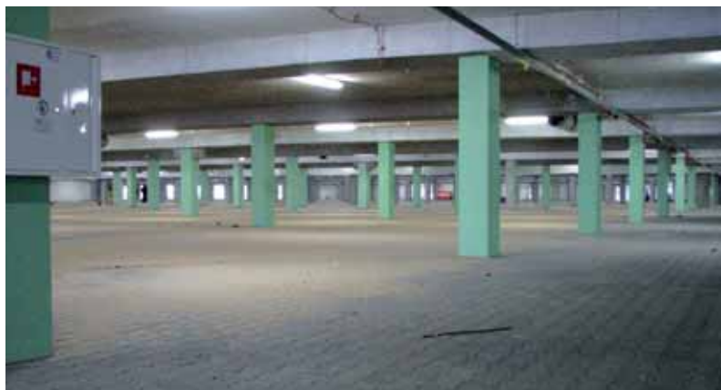
Problemem parkingów podziemnych jest bezpieczeństwo pożarowe i ewakuacja ludzi. Zastosowana w Carrefour wentylacja strumieniowa jest bezpiecznym, a przy tym unikatowym rozwiązaniem jak na nasz region.
