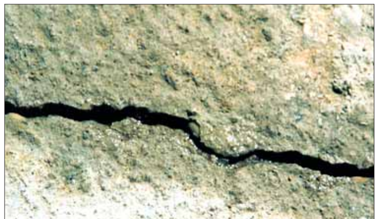
b) pęknięcie w strefie wieńca górnego
