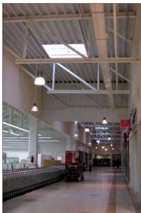
Na dachu zaprojektowano świetliki, klapy dymowe (widoczna na zdjęciu) i wylaz dachowy
