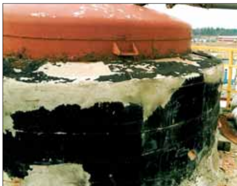
a) stan degradacji elementów,
