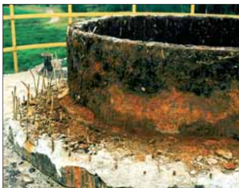
b) destrukcja będąca efektem wybuchu
