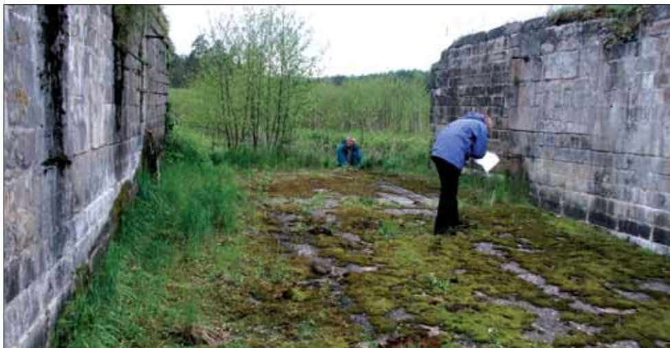
Niepracujący jaz Wołkuszek - przyczółki i płyta denna. Widok na jaz przed remontem od strony wody górnej
