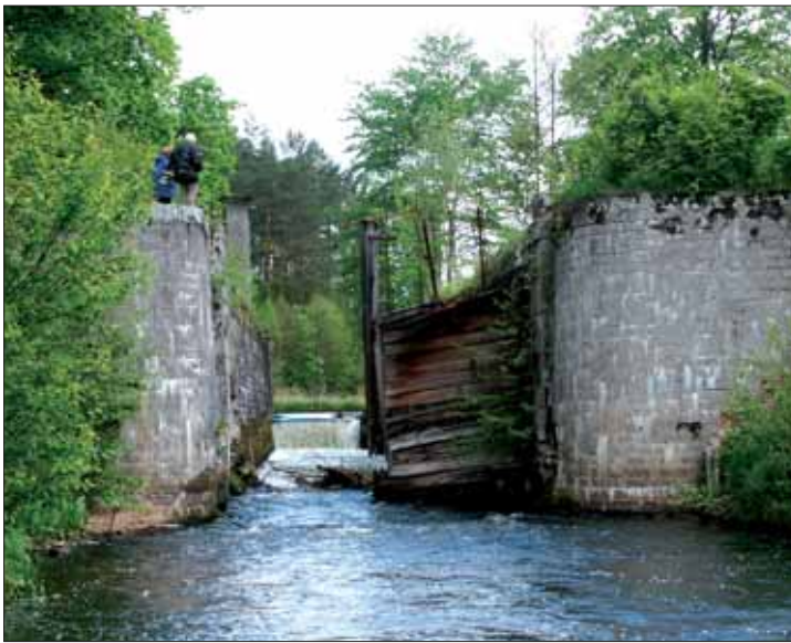
Śluza w Kurzyńcu – stan przed remontem. Widok na awanport dolny.
