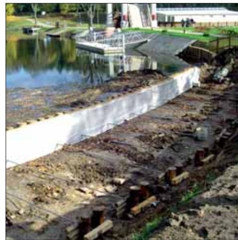
Remont kanału w części granicznej – na zdjęciu widać umocnienie brzegu palami drewnianymi
