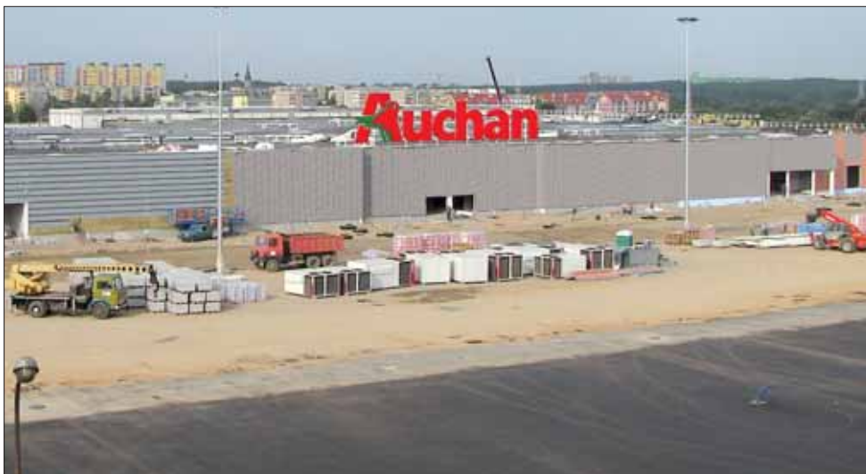
Widok powstającego obiektu od strony ulicy Hetmańskiej. Stan robót z połowy sierpnia br.
