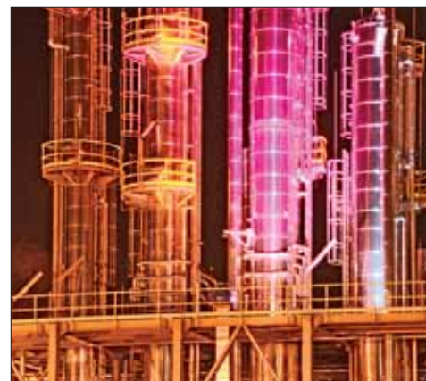
Zespół kolumn rektyfikacyjnych w Białymstoku przy ul. Elewatorskiej 20
