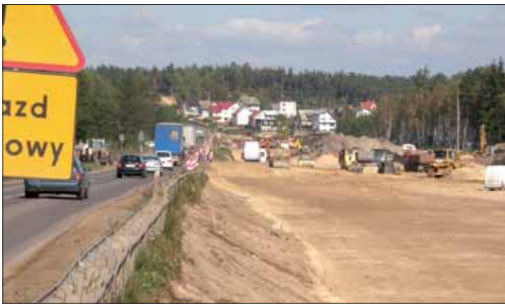
Przebudowywana droga jest odcinkiem podmiejskim, na którym panuje duży ruch. Utrudnieniem dla prowadzących roboty jest więc fakt, że nie jest on przerywany. Na zdjęciu – widok na Jurowce.
