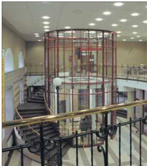
Stalowe balustrady antresoli, z mosiężnym pochwytem, wykonano z wypełnieniem kutą metaloplastyką, z aplikacjami odnoszącymi się do nielicznych motywów i zachowanych detali ślusarki historycznej
