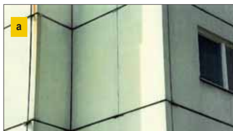
Rys. 3. Przykłady połączeń elementów ścian zewnętrznych: a) mechaniczne uszkodzenia krawędzi płyt prefabrykowanych, b) próba wadliwej naprawy złącza poprzez wypełnienie szczeliny pianką poliuretanową
