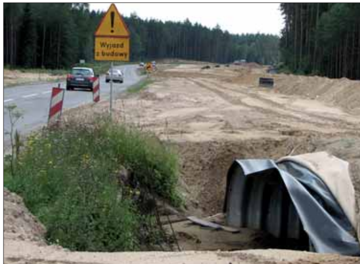
Przepust dla zwierząt i rowu melioracyjnego.
