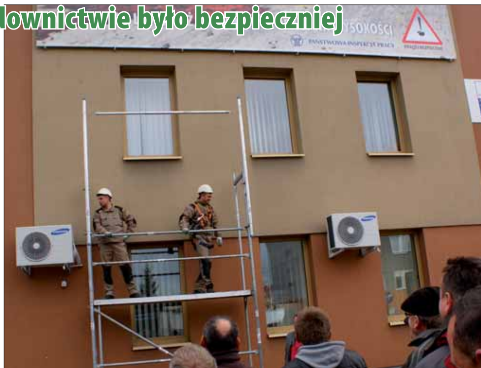
System zabezpieczeń przed upadkiem z wysokości podczas znoszenia rusztowań zaprezentowano przed budynkiem OIP
