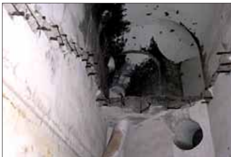
Zdjęcie Nr 1. Widok na resztki zbrojenia schodów żelbetowych
