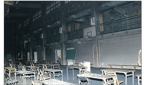
Rys. 3. Fragmenty konstrukcji budynku po zakończeniu gaśniczej akcji ratunkowej
