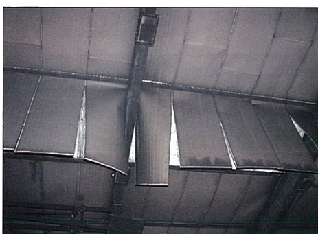
Rys. 4.a) Uszkodzenia wewnętrznej powierzchni płyt warstwowych.
