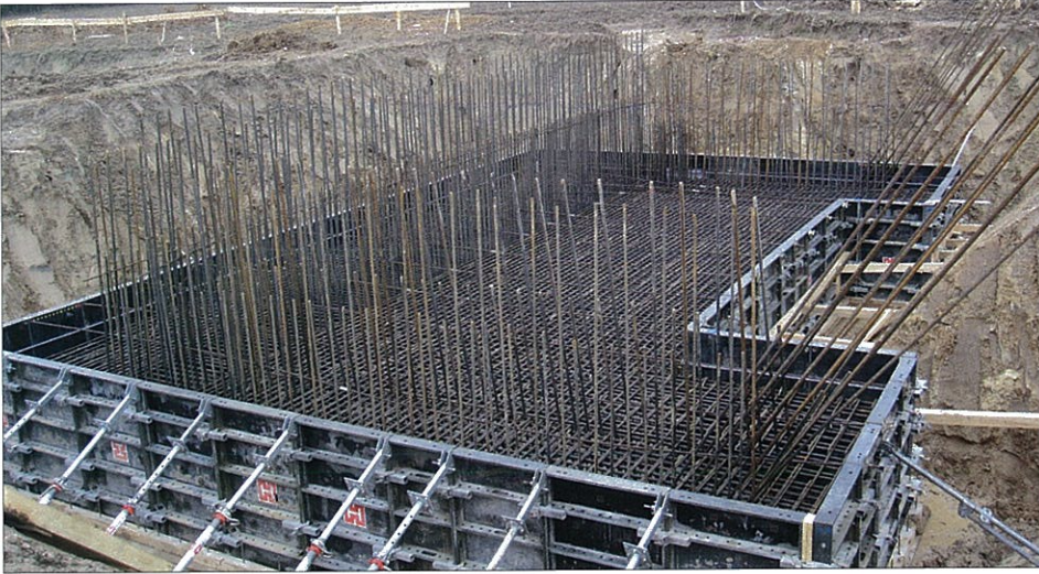
Ławy fundamentowe pod przejazd gospodarczy – droga nr 63 wyjazd na Łomżę obiekt nr 11
