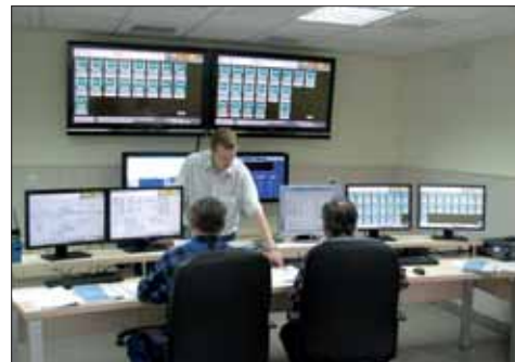
Sterownia Parku Zbiorników – po modernizacji
