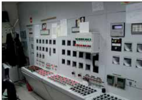
Sterownia Parku Zbiorników – przed modernizacją
