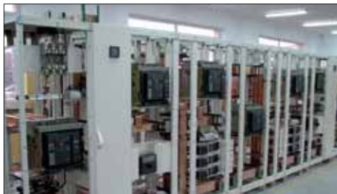
Rozdzielnica R1 SIVACON Siemens, Jn=4.000A, Icc=65kA, IP=30, ilość pól – 11 – w trakcie produkcji
