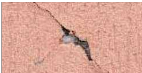
Zniszczona elewacja i ocieplenie budynku
