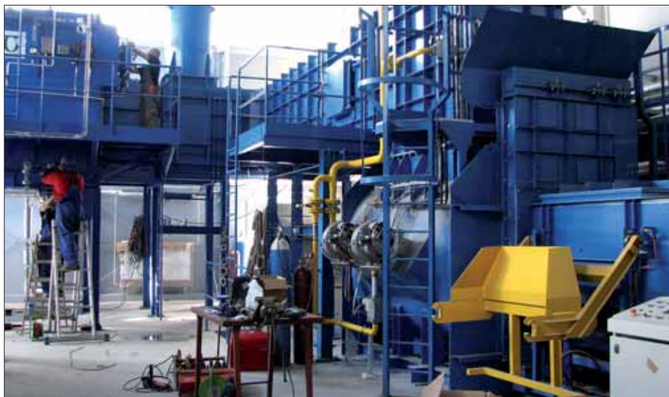
Serce instalacji, czyli piec typu HP 750 o wydajności 200 kg/h odpadów o kaloryczności 14,7MJ/kg, dwukomorowy, z automatycznie załączającymi się palnikami gazowymi w komorach: spalania odpadów i dopalania gazów spalinowych oraz z szafą sterowniczą.
