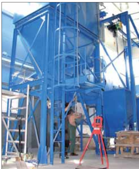
Trzystopniowa, bezściekowa stacja oczyszczania spalin typu suchego gwarantuje dotrzymanie obowiązujących norm emisyjnych
