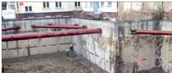
Rys. 6 Zejście do II poziomu dna wykopu i przygotowanie frontu pod montaż II poziomu rozparcia
