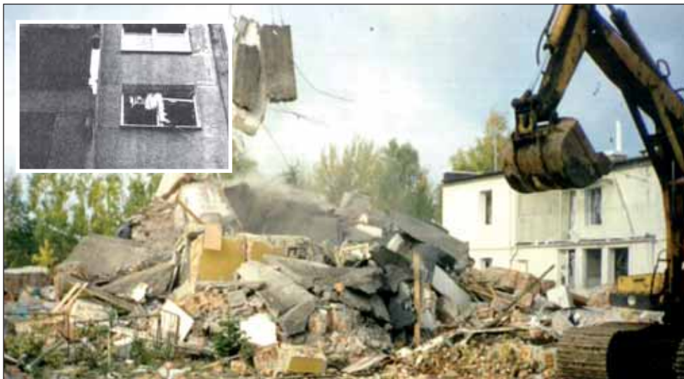
Konsekwencje wybuchu gazu w budynkach mieszkalnych
