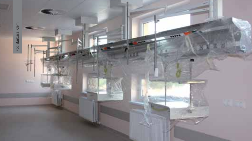
Oficjalne otwarcie nowej części placówki zaplanowane jest na 26 września br. Do końca roku ma być uruchomiony cały obiekt. Na zdjęciu – sala wybudzeń.
