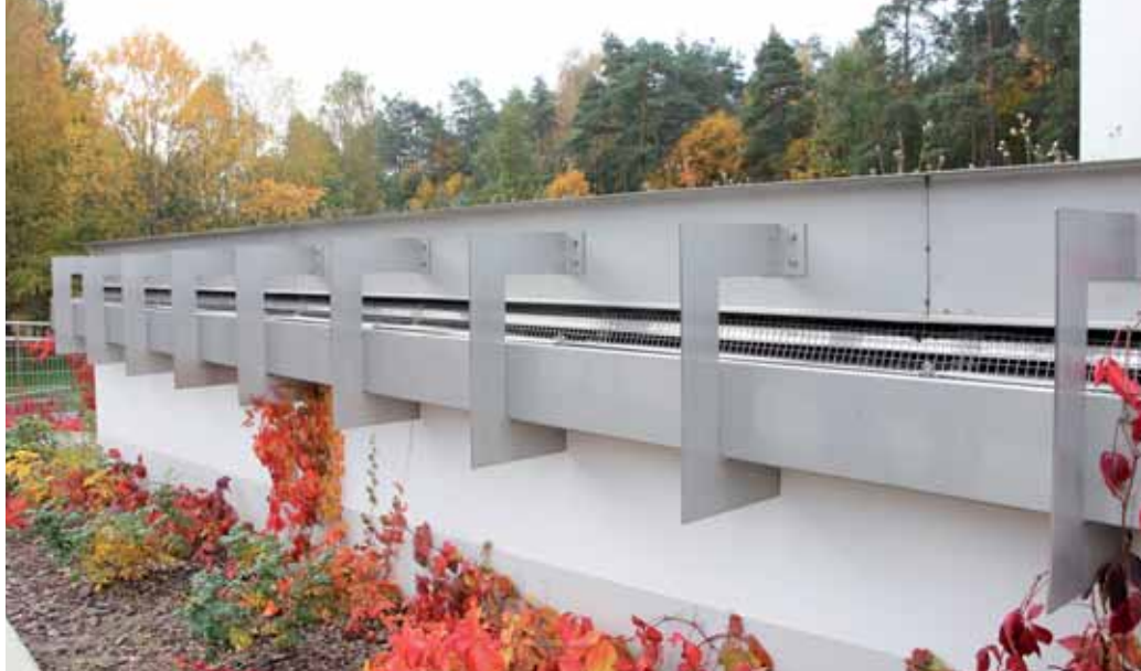
System odprowadzania wód deszczowych jest zamknięty, nie ma połączenia z kanalizacją burzową. Jeszcze nie przeżył nawałnicy, trudno więc przewidywać, jak będzie pracować. Na zdjęciu fragment gzymsu dachu z orynnowaniem.
