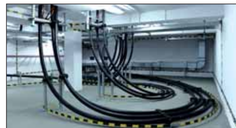
Pomieszczenie kablowni 110 kV.
