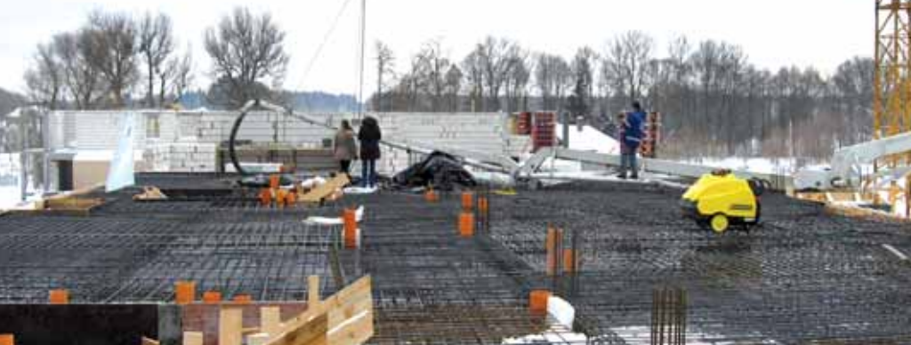
W trakcie pompowania betonu na strop pierwszej kondygnacji pękł profil masztu dystrybucyjnego i jedna z jego sekcji upadła na dwóch pracowników, rozgarniających beton. Obaj zginęli.
