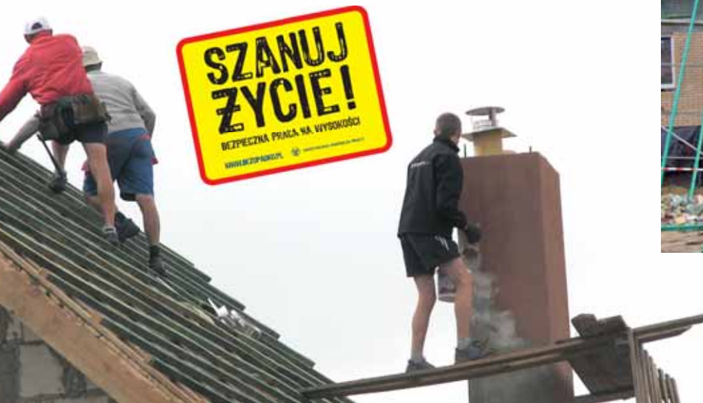
Przypadkowo zastana przez inspektorów sytuacja na budowie, na szczęście, bez wypadku.
