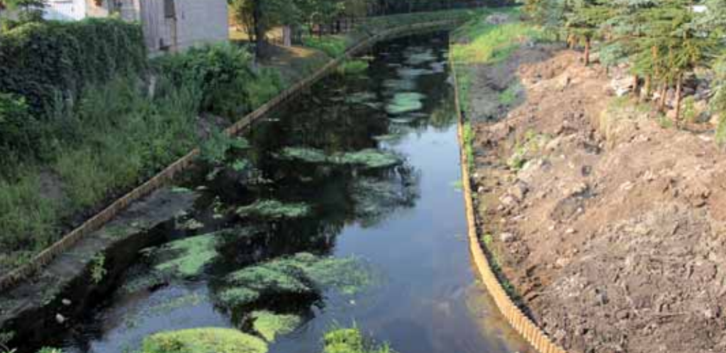
Biała stwarza dla Bielska problemy nie tylko w rejonie ul. Kazimierzowskiej. Podtopienia występują również w okolicy ul. Zamkowej. Na zdjęciu – stan prac na początek sierpnia.
