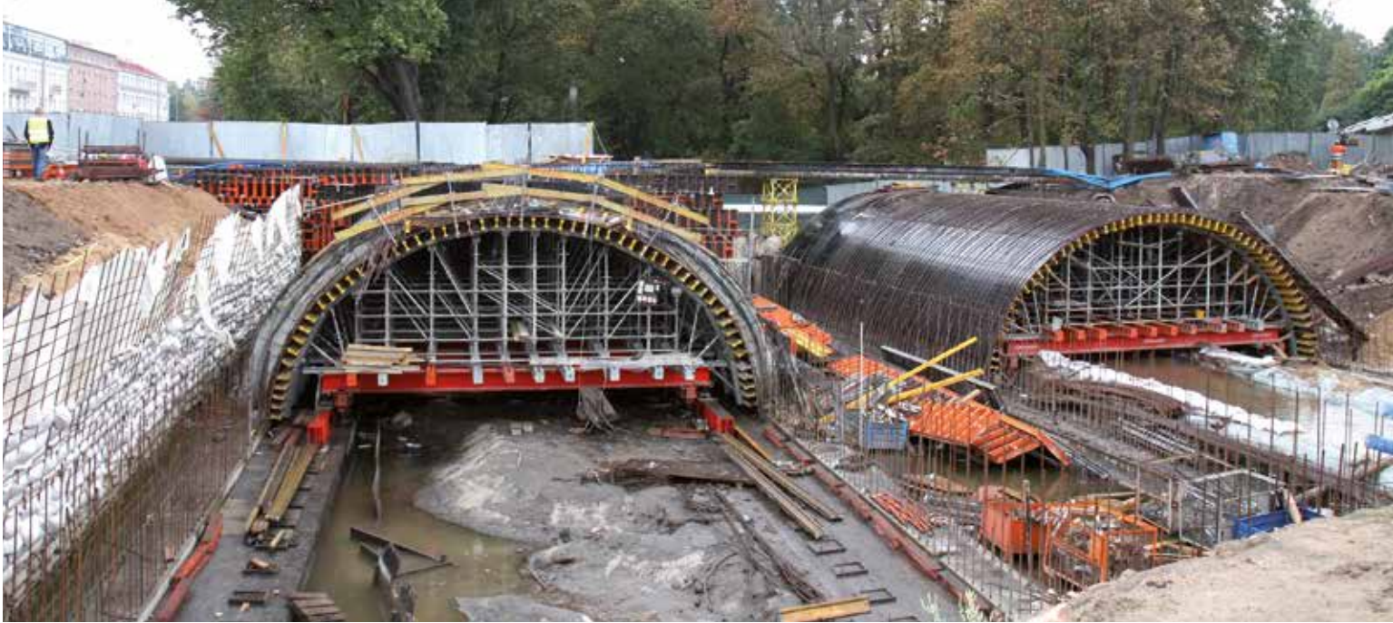
W nowatorski sposób wykonane zostało deskowanie konstrukcji mostu i tunelu. Fachowością popisała się tu nasza lokalna firma Palisander Białystok.
