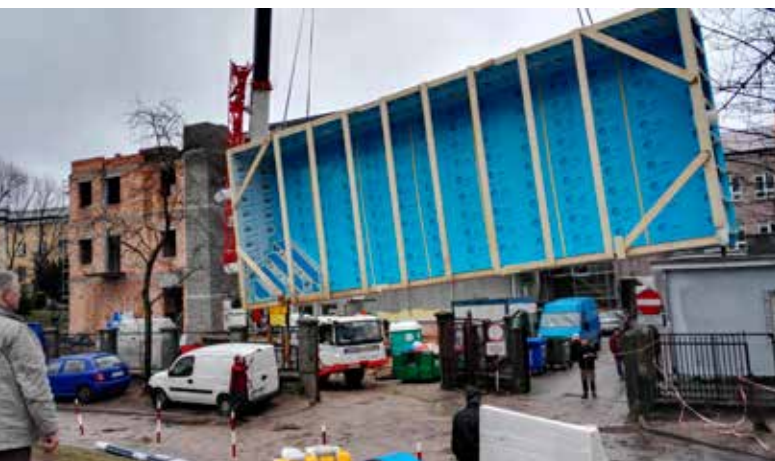
Ósmego marca br., na najwyższe piętro przyszłego Royal Hotelu dźwig podniósł niekę basenu. Wydarzenie obserwowali inżynierowie i mnóstwo gapiów
