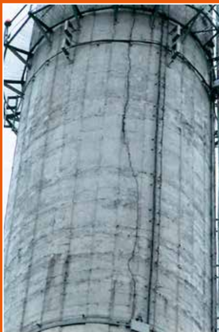
Spękany płaszcz komina [7] i lokalna korozja betonu. Po analizie statyczno-wytrzymałościowej podjęto decyzję obniżenia wysokości komina.
