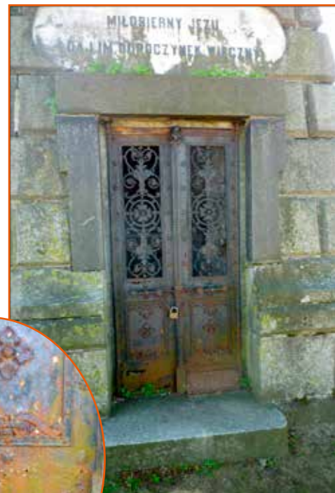
Silnej korozji uległy dwuskrzydłowe drzwi stalowe ze zdobieniami. Inżynierowie odtworzyli skorodowane skrzydła i detale kraty ozdobnej
