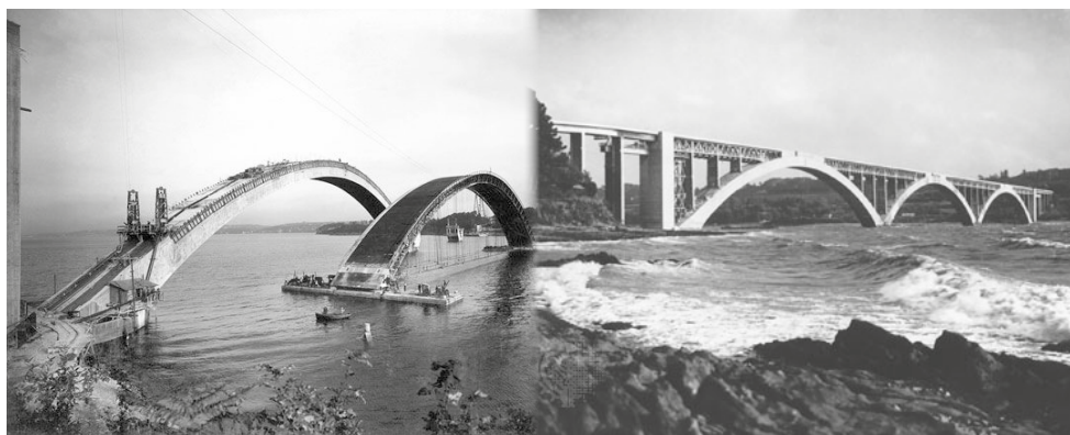
Budowa mostu łukowego w Plugastel pierwszego nowoczesnego mostu żelbetowego, skonstruowanego w 1929 roku w Breście przez E. L. Freyssineta
