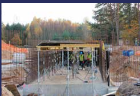
Przejście dla pieszych podczas prac zbrojarskich i ciesielskich, przekrój 2,5x4,5 m, długość 25 m. Nie rozpoczęły się jeszcze prace przy budowie wiaduktu Ignatki Księżyno – monolityczna rama zamknięta
