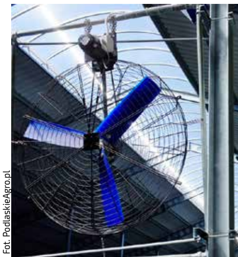
Wentylację obory zapewniają zautomatyzowane kurtyny na ścianach bocznych oraz wentylatory mieszające powietrze wewnątrz
