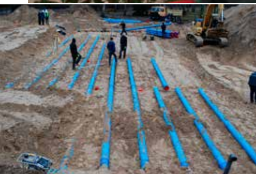
Łączna długość rur gruntowego wymiennika ciepła pod budynkiem to 1.400 m.
