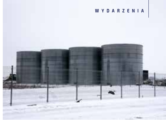
Zbiorniki na wodę do celów pożarowych z dedykowanym budynkiem pompowni. Jako rezerwowe zasilanie zastosowano pompy z napędem silnikami diesla
