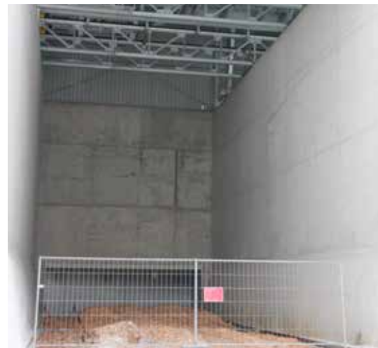
Jeden z zadaszonych zasieków na zrębki napelniany ruchomymi taśmociągami od góry, a opróżniany od dołu ruchomymi podłogami, podającymi materiał na przenośniki za tylną ścianą
