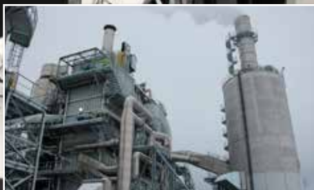
Po lewej kocioł na biomasę o mocy 49,9 MW. Po prawej mokry filtr elektrostatyczny wychwytyjący cząstki stałe, z wylotem na poziomie +40 m emitującym parę wodną
