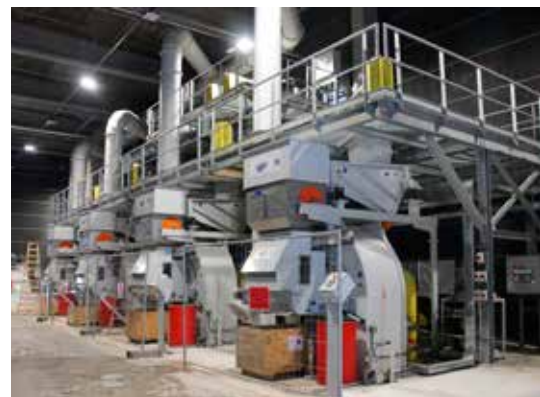
Urządzenia rozdrabniające zrębki na wióry z kompletnym odpylaniem. Obok mieści się zrobotyzowana ostrzalnia narzędzi
