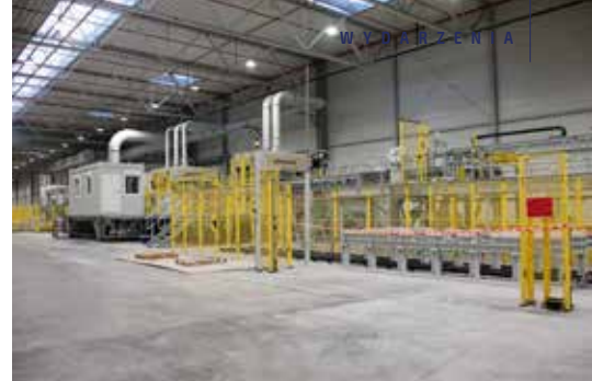
Linia szlifowania płyty wiórowej – precyzyjnego przygotowywania powierzchni i grubości pod okleinowanie. Przewody odpylające o średnicy 120 cm
