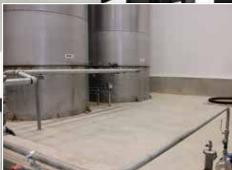
Zbiorniki komponentów do przygotowania spoiwa płyty przy tzw. „kuchni klejowej”
