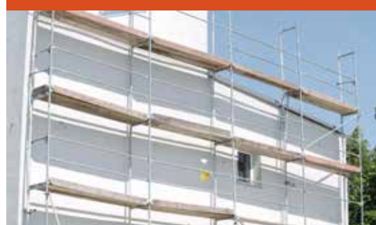
9. Brak poręczy, krawężników, pomostów, stężeń
