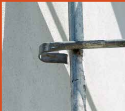
12. Mieszanie typów rusztowań - Nieprawidłowa poręcz poprzeczna
