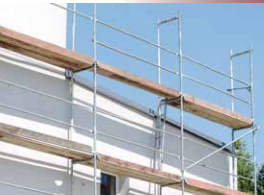
10. Brak kotwienia najwyższego poziomu roboczy rusztowania
