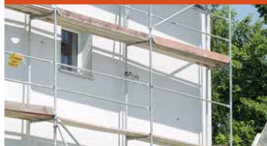
7b. Wykonanie kotwienia pod niedozwolonym kątem, brak krawężników, poręczy głównych i czołowych, stężeń
