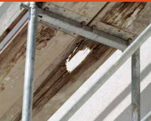
11. Wyeksploatowany uszkodzony pomost roboczy drewniany
