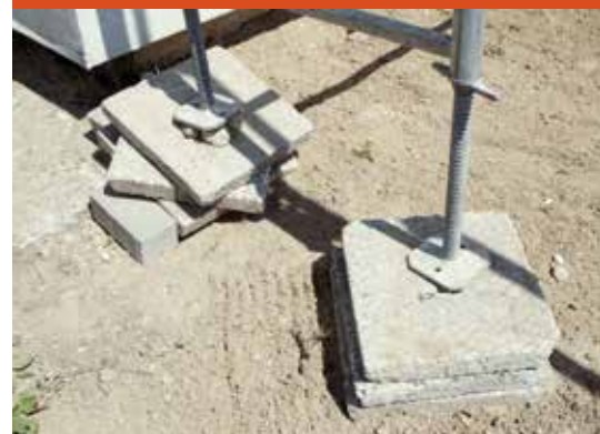
5. Nieprawidłowe posadowienie rusztowania
