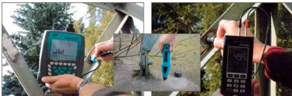
Dokumentacja nieniszczących badań stali i betonu zrealizowanych „in situ”. Ponieważ nie było szczerogółowej dokumentacji projektowej zrealizowaliśmy szereg badań, wizualnych, nieniszczących z wykorzystaniem specjalistycznej aparatury ultradźwiękowej oraz badań wytrzymałościowych
