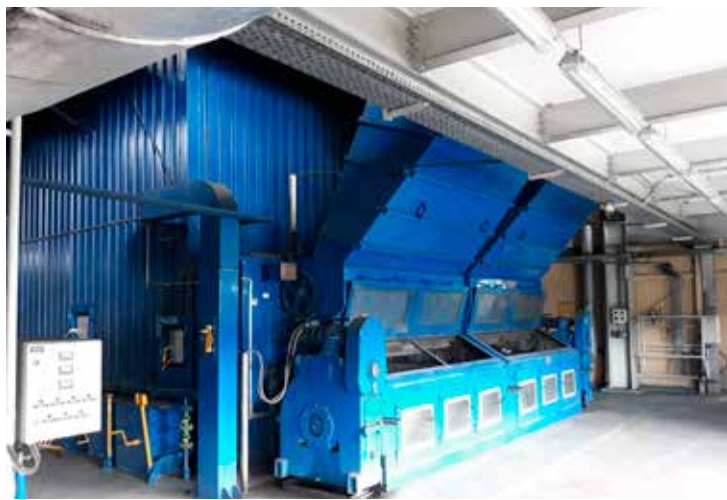
Kocioł węglowy WR 25 przed przebudową
