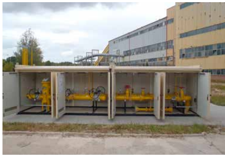
Stacja gazowa redukcyjno-pomiarowa
