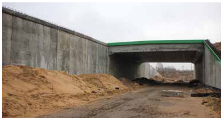
Od wjazdu do Biedronki zmieni się przebieg ulicy Klepackiej, znikną dotychczasowe „eski”, ulica zostanie wyprostowana. Na pierwszym planie wiadukt nad rozebranymi torami, daleko w tle drugi nad czynnym torowiskiem
