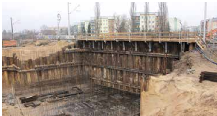
Podchodzimy do drugiego wiaduktu, jest już gotowa jego część. Bliźniacza powstanie po drugiej stronie i na obu zostaną oparte tory, by dokończyć prace
