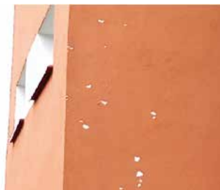
Widok ściany z odspojeniami mineralnego tynku cienkowarstwowego pokrytego farbą silikonową (Marcin Kanoniczak, 2017)
