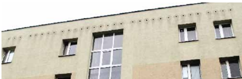
Kondensacja pary wodnej u wylotów otworów w dachu (Piotr Knyziak, 2014)
