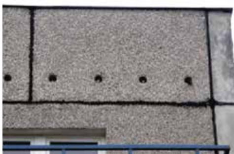
Doszczelnione złącza prefabrykatów (Piotr Knyziak, 2014), ubytki na krawędziach (Janusz Krentowski, 2019)
