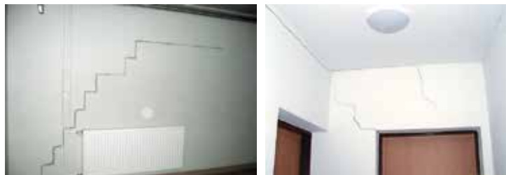
Fot. 1. Zarysowana ściana wypełniająca w budynku wielorodzinnym
