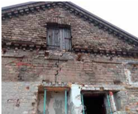
Budynek w Jabłoni Kościelnej był w bardzo złym stanie technicznym, ściany zewnętrzne murowane z cegieł ceramicznych miały liczne spękania i rysy
