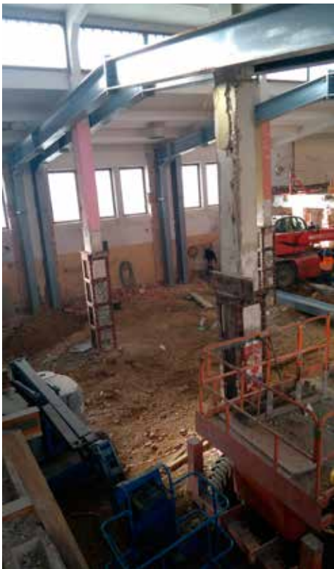
Moment przygotowania do zburzenia czterech słupów nośnych. Na zdjęciu po raz ostatni stare słupy i nowa konstrukcja stalowa
