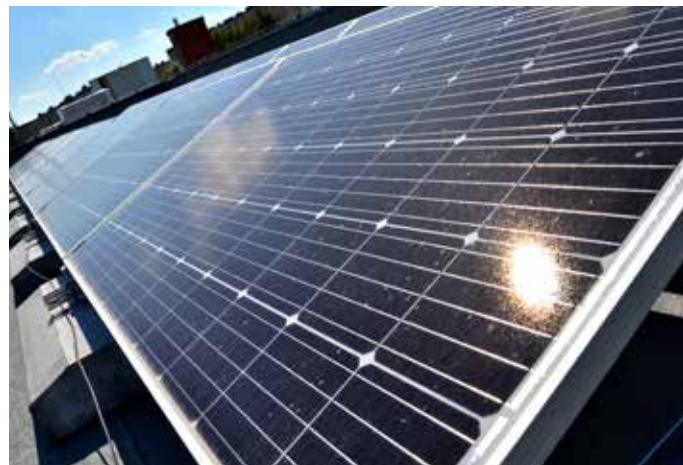
Instalacja fotowoltaiczna na dachu
