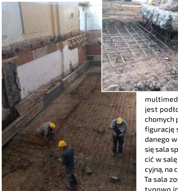
Pogłębienie piwnicy i budowa ściany dociskowej. Na małym zdjęciu widać murowany fundament słupów
