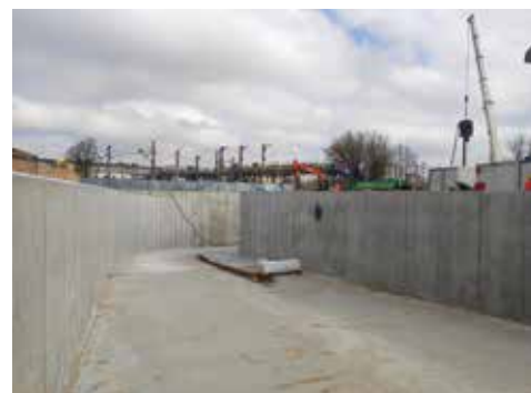
Prace obejmują też połączenie tunelu z ulicami: Kolejową i Zwycięstwa oraz św. Rocha. Na zdjęciu pochylnie wprowadzające ruch do głównego przejścia
