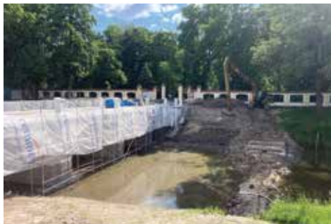
– Usypaliśmy groblę ziemną, wypompowaliśmy wodę i przenieśliśmy ryby. Prace prowadziliśmy więc na sucho – relacjonuje Oskar Kielczyk, kierownik budowy
