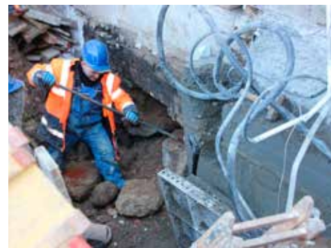
Ściany nośne wzniesiono z cegły pełnej ceramicznej na fundamencie z cegieł i kamieni. Budynek nie jest podpiwniczony
