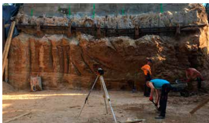
Wykop należało zabezpieczyć przed „podkopaniem” się na głębokość 6 m poniżej istniejącego fundamentu przyległego zabudowania, palami typu jet-groundig
