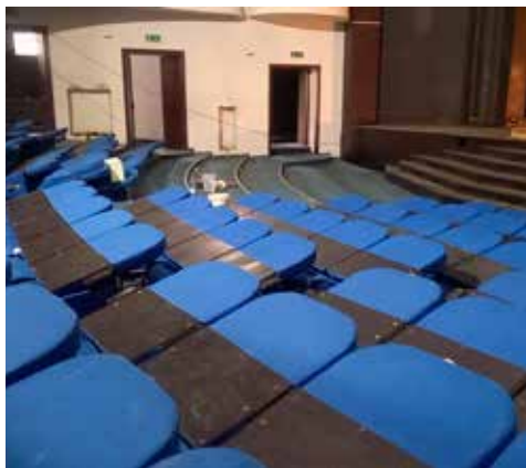
Przebudowa obejmie wymianę stolarki i ślusarki. Widzowie zyskają nowe fotele, a – dzięki innowacyjnym rozwiązaniom z zakresu mechaniki sceny – wzrośnie atrakcyjność prezentowanych spektakli
