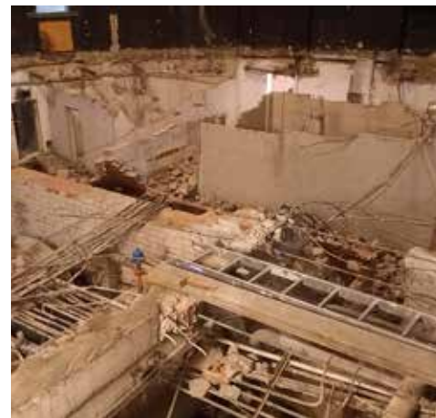
Tego typu inwestycje rozpoczynają rozbiórki i demontaże. Zabytki kryją wiele niespodzianek. Nie dano się ich uniknąć i w tym przypadku
