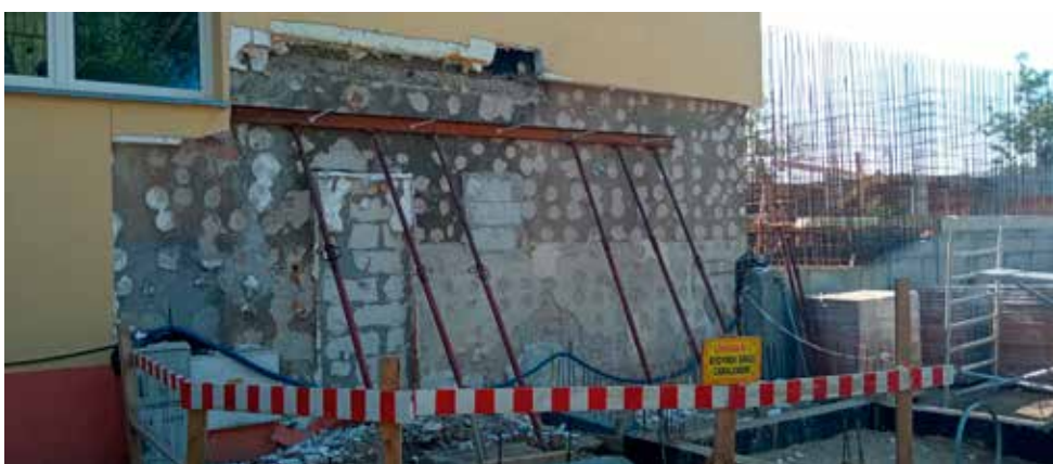
Ściana zagrożona zawaleniem
